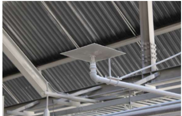
Placas artesanales “Colectoras de calor” en rociadores[iii] (Ver tecnicnota N°23)
