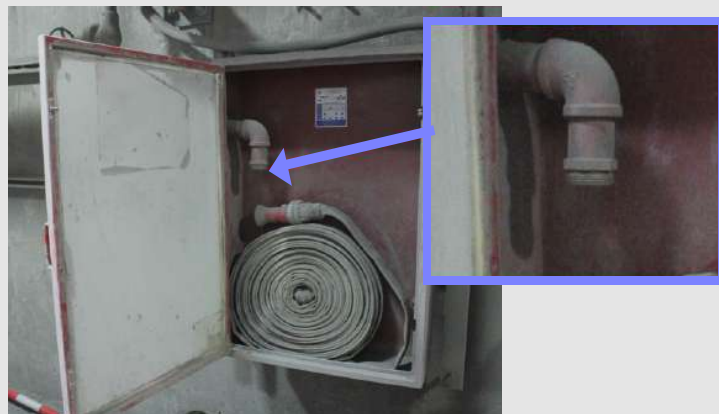
Gabinete de manguera Exterior OK - Interior sin válvula de conexión
