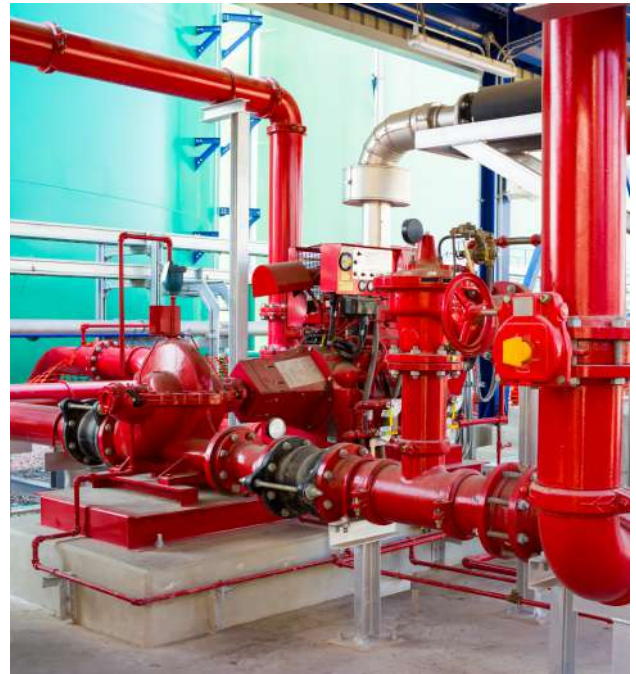
Sistema de Bombeo Diésel
