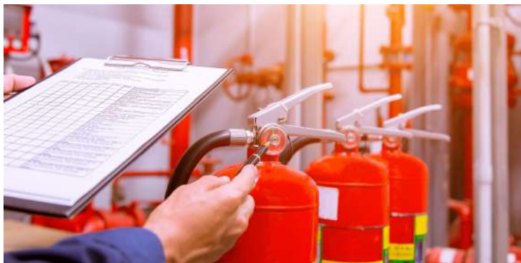
Inspección de Extintores
