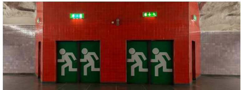
Figura 2: Puertas de salida de emergencia
