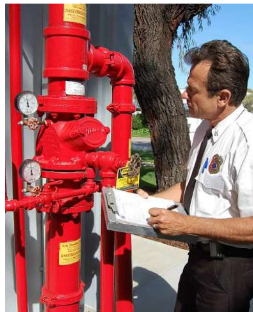
Revisión de sistema de rociadores.
